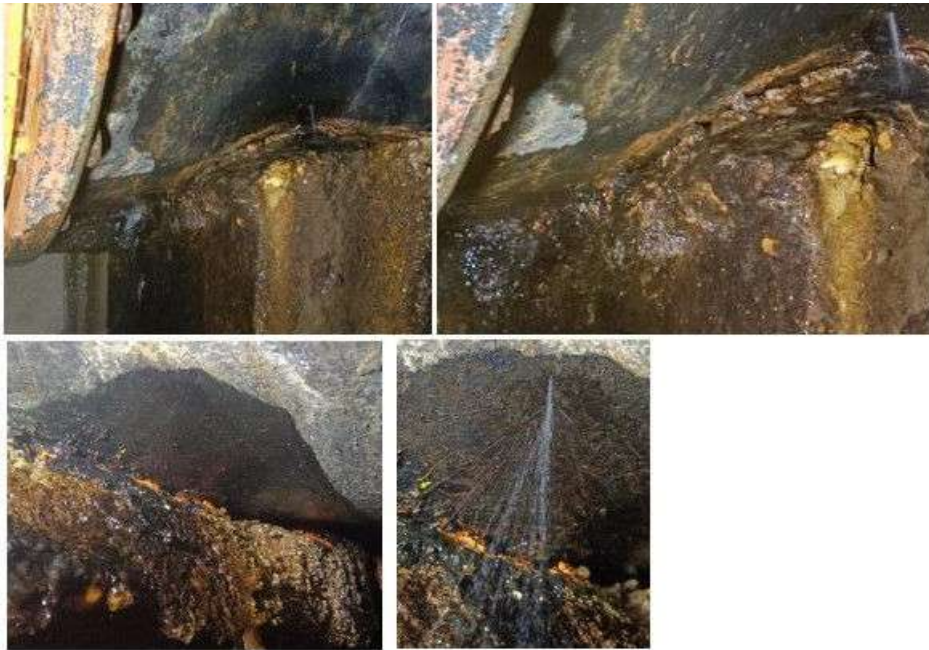
Deterioro de las válvulas de la presa de Eiras, que suministra a Vigo y a varios municipios del área.
